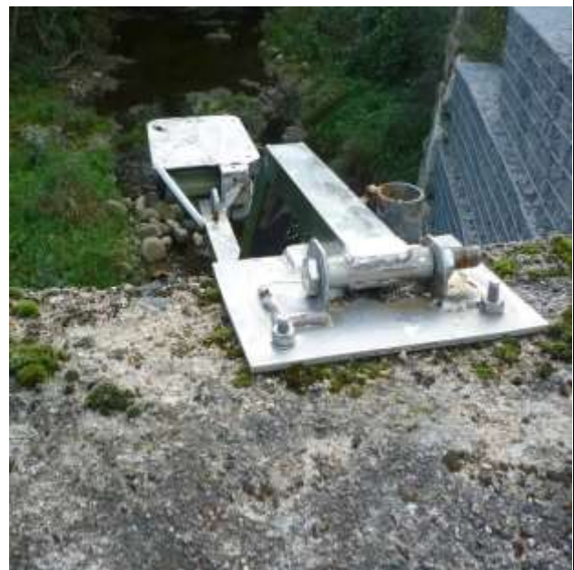
Capteur vissé sur le pont
